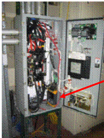
BLDG 601 Curing Oven 1 ATS
